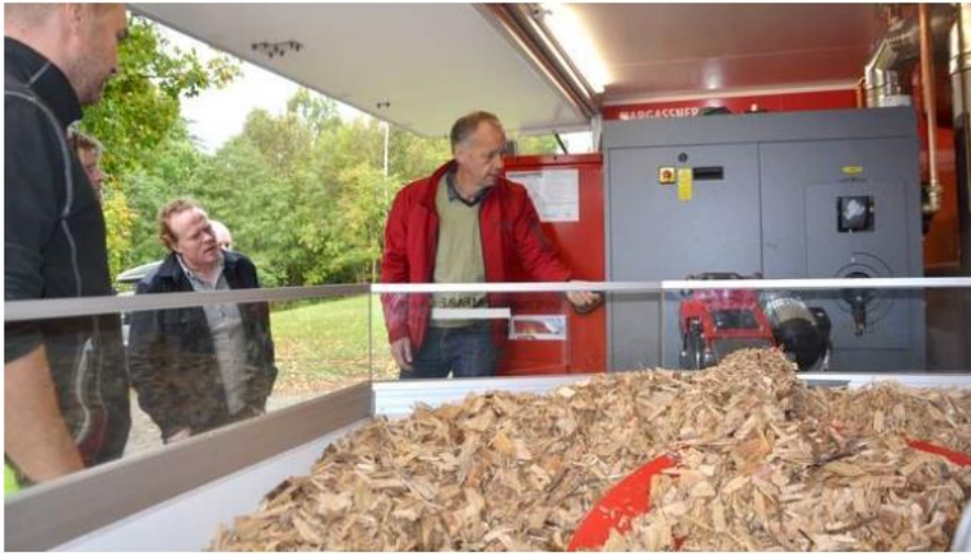
VISER. Trond Hamneren demonstrerer hvordan flisfyring fungerer.
