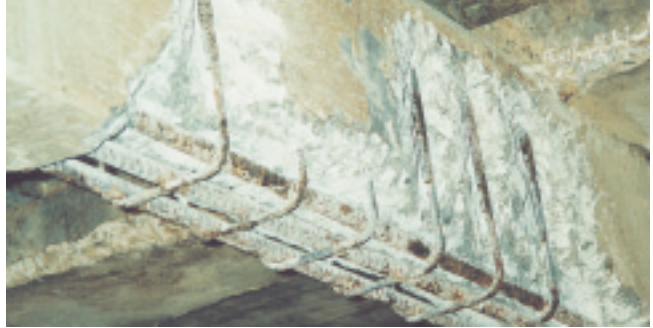
Typisk skade på drager under gjødselrist. Korrekt meisling er 2 cm bak armeringsjernene og ca 5 cm inn langs blåfarget jern i lengderetningen. Videre meisles en skrå kantavslutning ved reparasjon med sprøytebetong og rett kant ved reparasjon med handmørtel.
