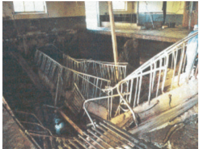
Sammenbrudd fjøsgolv. Gjødselkjelleren bør inspiseres av brukeren eller evt fagfolk med jevne mellomrom som en del av rutinene for sikkerhet og kvalitetssystem på garden. Dette vil gi trygghet.
