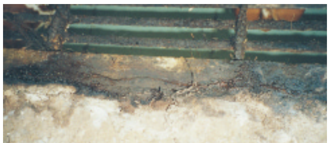
Den våte kanten langs ristopplegget er svært utsatt for skade og bildet viser tydelig sprekk her.
