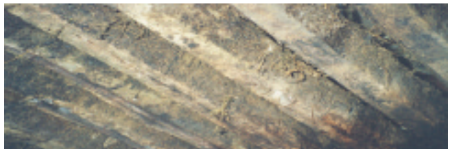
Tydelig langsgående sprekk på betongspalteplank, rett under hovedarmeringen.
