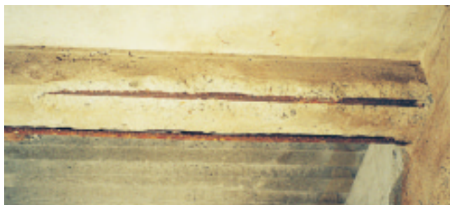
Drageren mangler bøylearmering og har derfor fått stor skade. Armeringsplan var ikke utarbeidd. Drageren ble stemplet opp ved undersøkelsen.
