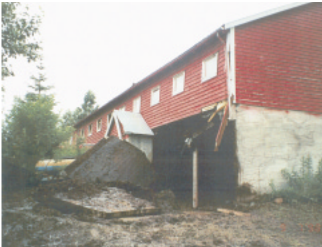
Sammenbrudd i utvendig kjellervegg Slik kan det i verste fall gå. Kjellerveggen sviktet.
