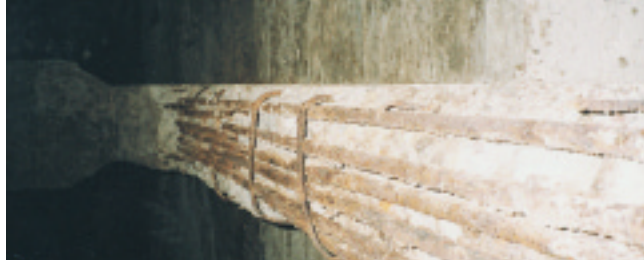
Betongsprengning og frilegging av armeringsjern. Bøylearmeringen og deler av strekkarmeringen er delvis rustet bort og jernene mangler forankring. Skadeårsak er karbonatisering. Drageren ble stemplet opp ved synfaringen.
