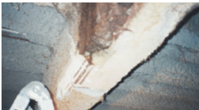
Her er det nyttet sprøytebetong på hoveddrager og dekke. Blir ikke arbeidet i forkant av påstøp utført på en korrekt måte er det ingen hensikt i reparasjonen. Sprøytebetongen er her bare kosmetikk og løsner i store flak. Også dette bildet viser situasjonen 8 år etter at arbeidet er utført.
