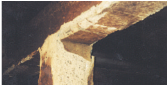
Syretæring av drager og søyletopp ved Gjermundnes videregående skole (Landbruksskole).
