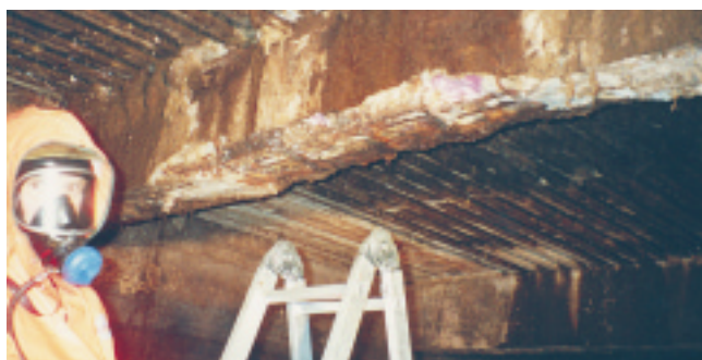
Betongsprengning og armeringskorrosjon på grunn av inntrengning av lann og gjødseel gjennom porer. Drageren hadde ca 30 % reduksjon av tverrsnittet på strekkarmeringen og skade nær opplegg. Den ble stemplet opp ved undersøkelsen. Konstruksjonen var ikke gammel og medvirkende skadeårsak var meget dårlig og åpen betong.
