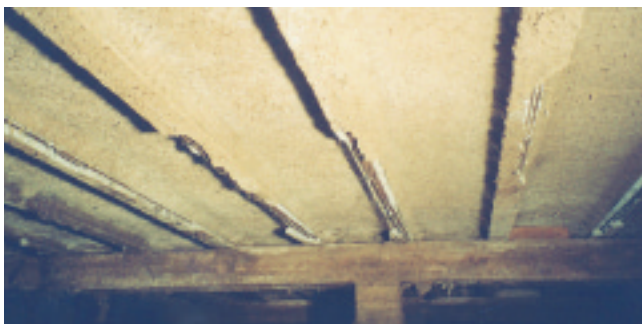
Stor skade på Ribo-dekke og sprengning helt inn mot opplegg.
