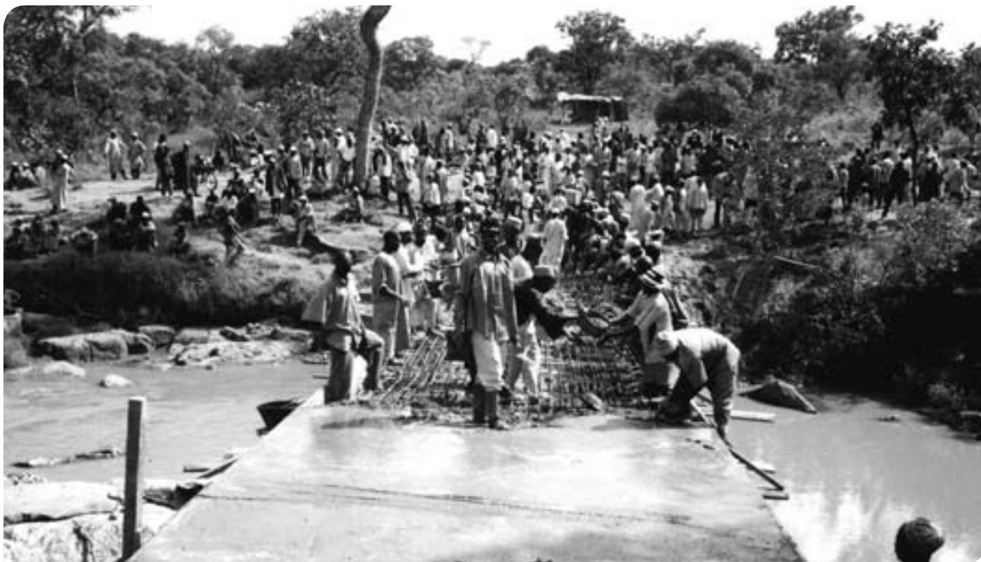
Her nærmer broen ved Djem seg ferdig, det meste er støpt, og resten er armert. Det er godt om arbeidskraft når det bare er penger til materiale.
