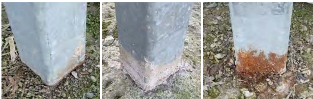
Ulike stadier av korrosjonsangrep i bunn av innstøpte stolper av galvanisert stål
